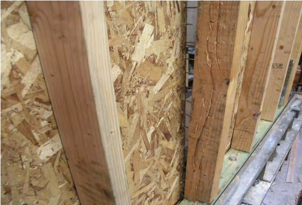
Figure 20. Splitting of center stud (Wall H1)
